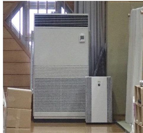
エアコン(室内機)
