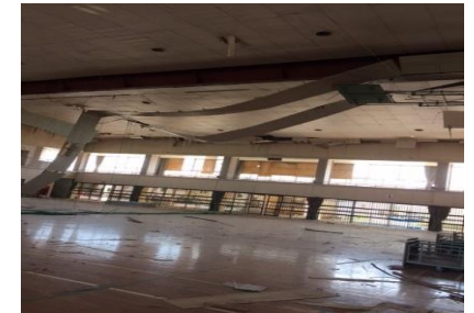
天井の一部が落下した体育館
