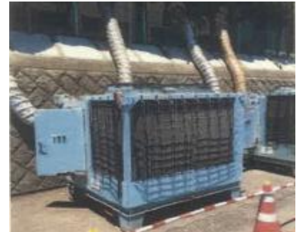
エアコン(室外機)
